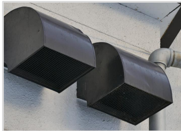
【ダクト清掃各種（要現地見積）】
